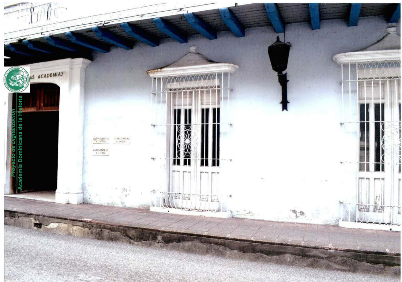
Estado de deterioro en el que se encontraba la fachada de la Casa de las Academias.
