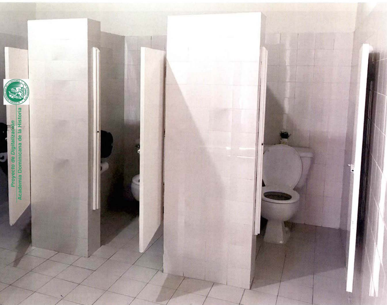
Estado del baño de damas del segundo piso.
