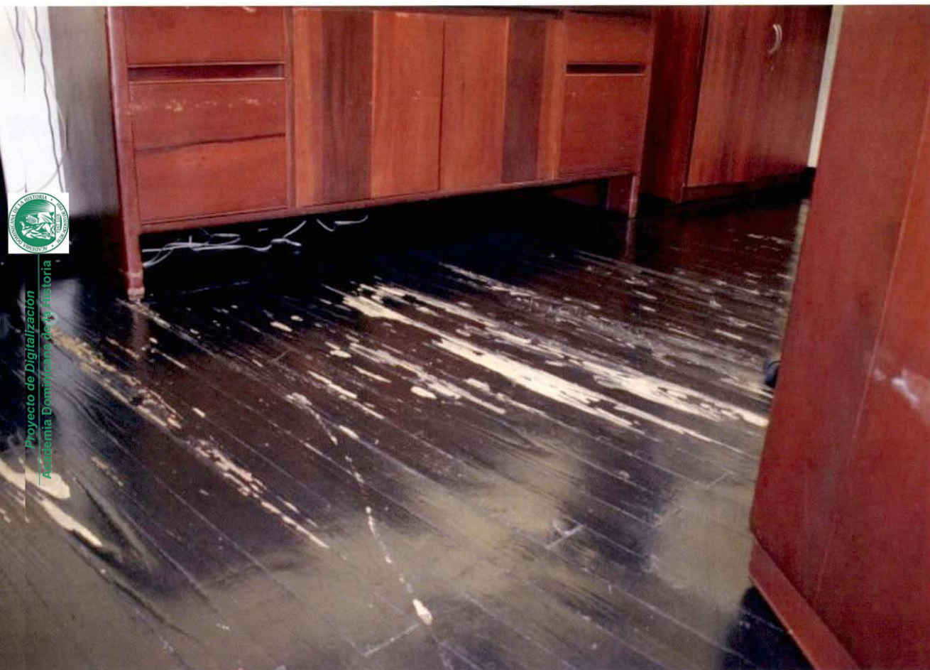
El piso de madera de la oficina de la presidencia se veía de esta manera.
