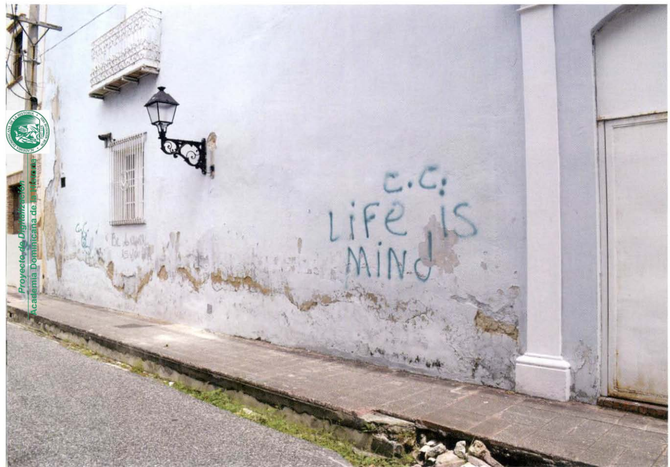
Fachada posterior de la Casa de las Academias desvencijada.
