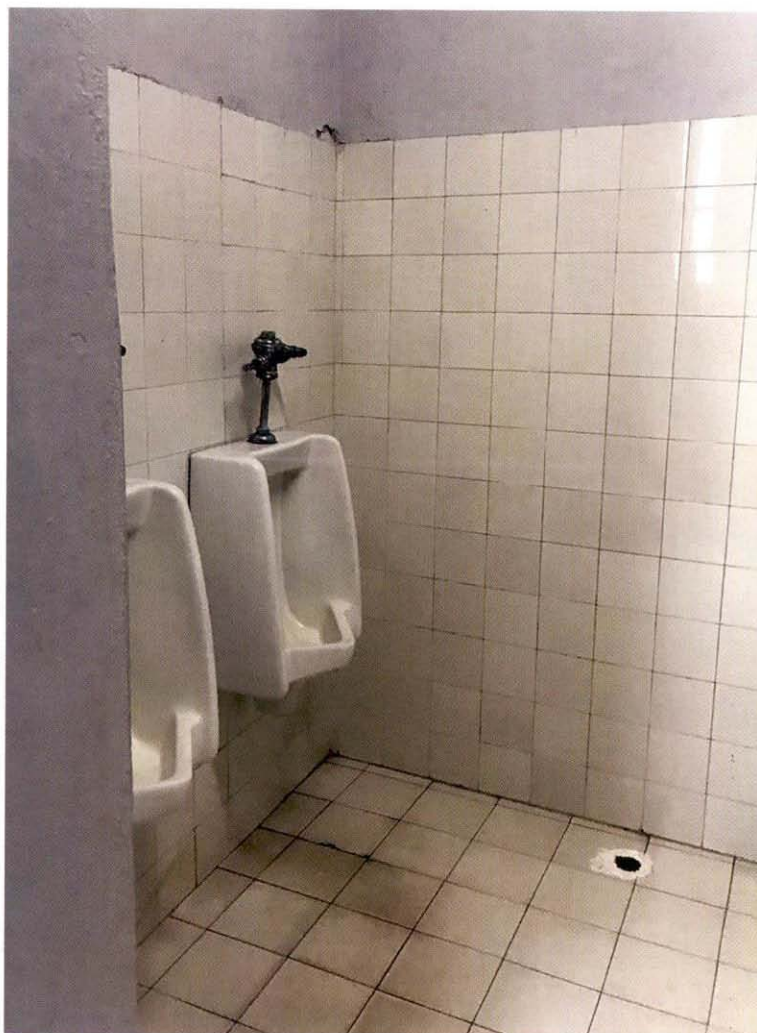
Estado del baño de caballeros del segundo piso.
