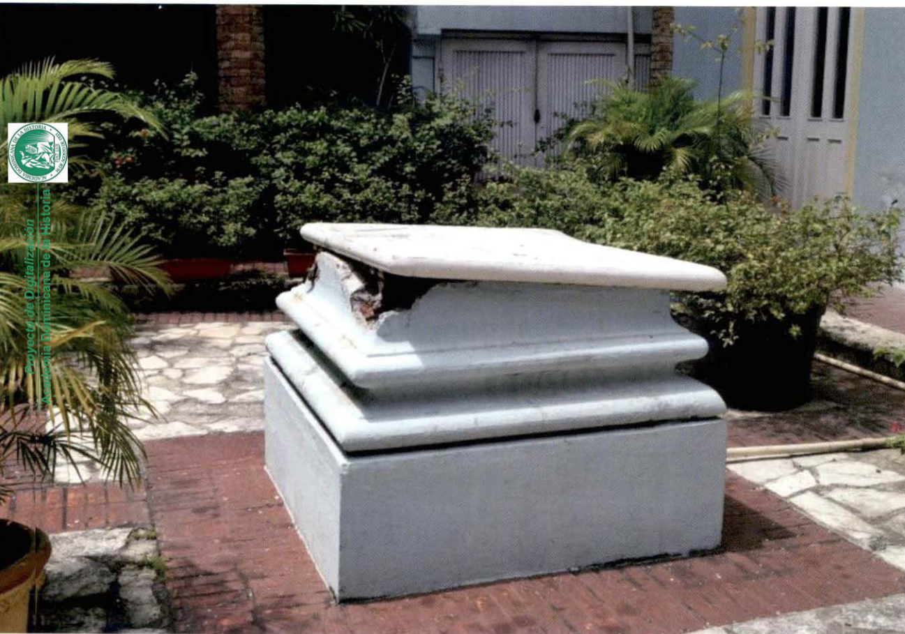
Tapa rota de la cisterna ubicada en el patio central.
