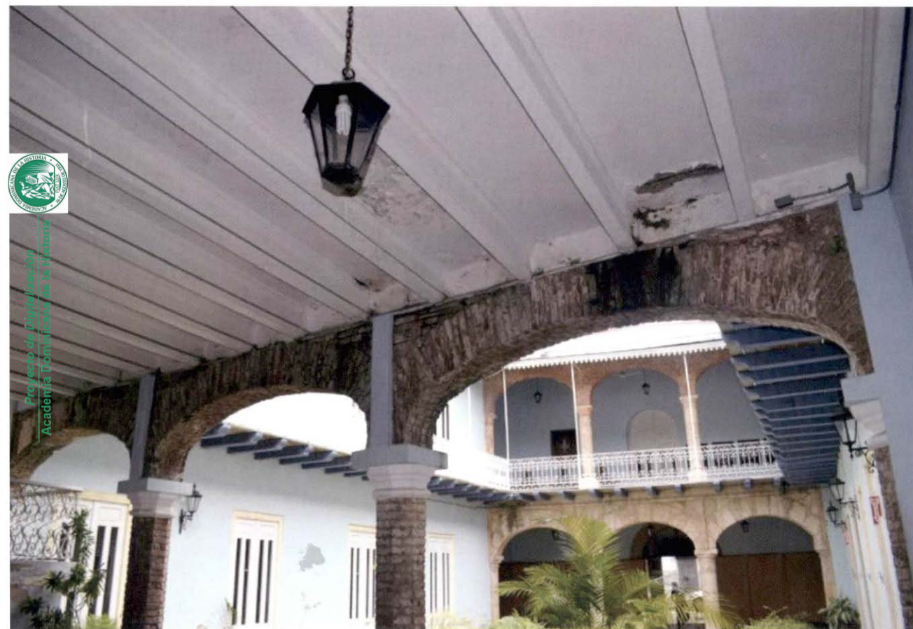
Techo y arcos de la parte posterior del patio central de la Casa de las Academias en franco deterioro...
