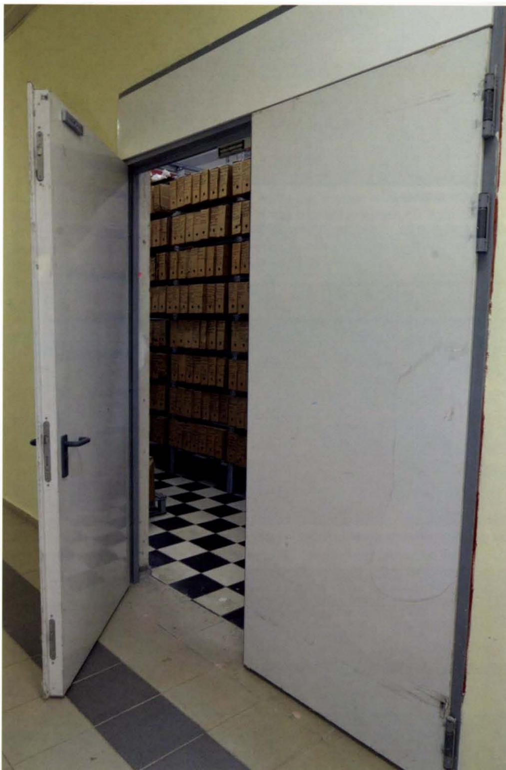
Puerta contra incendio.
