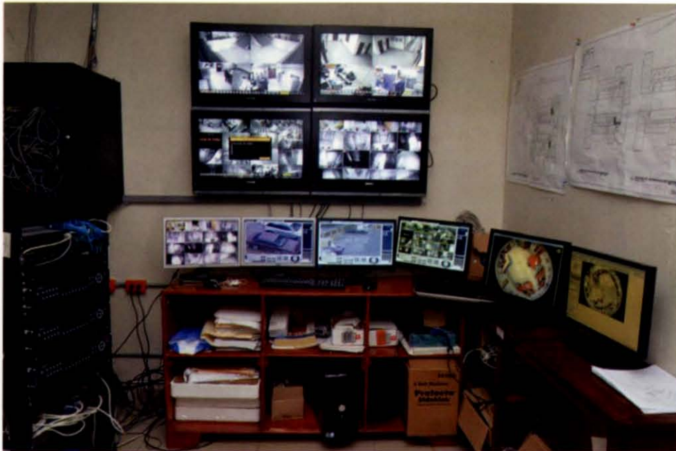
Sistema de seguridad.
