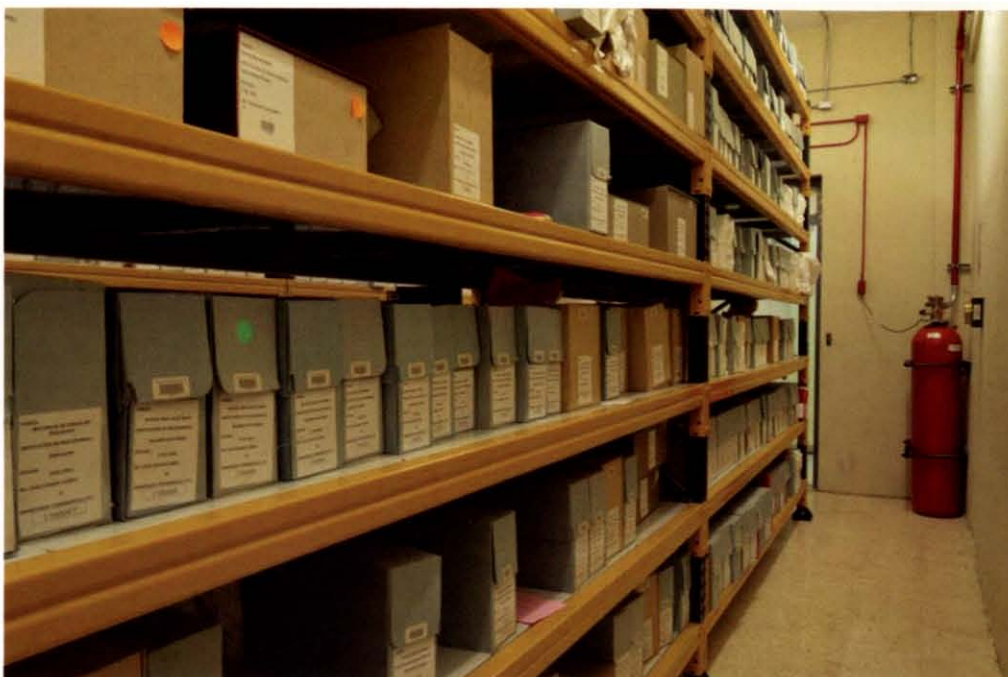
Al fondo tanque FM 200 que forma parte del sistema de supresión de incendio.
