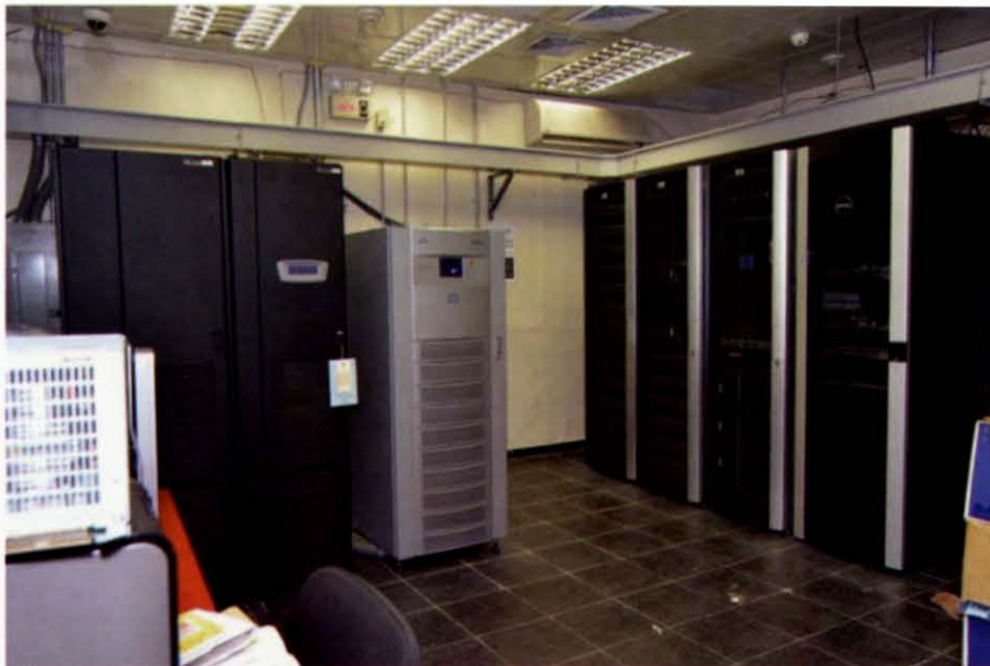
Servidores de almacenamiento y UPS que forman parte del Data Center.
